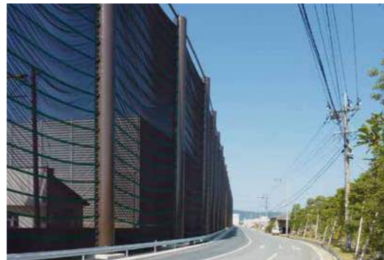
唐津港防砂ネット 佐賀県 / H=21.5 m (防砂) / DHT
